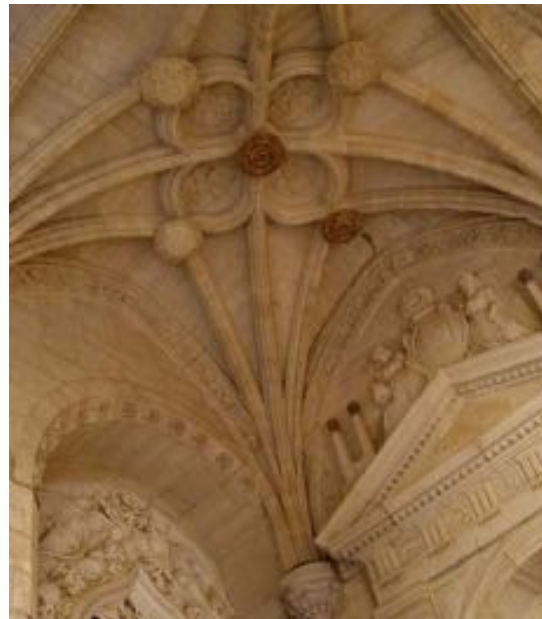
Bóveda de combados del claustro de la Catedral de Segovia de Juan Guas
