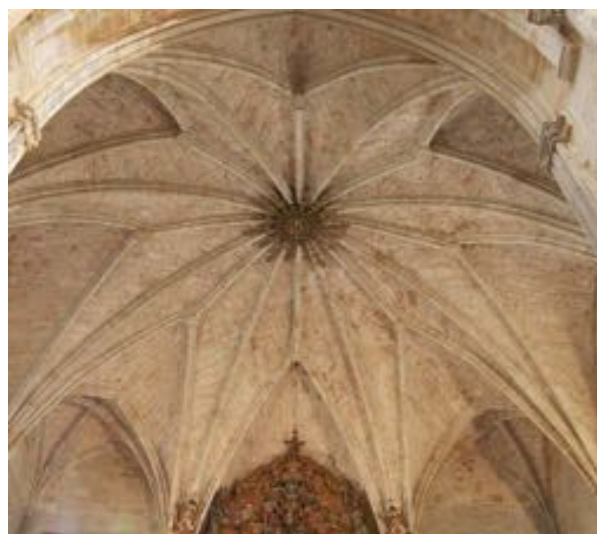
Esquema y vista de la bóveda estrellada de la cabecera del Monasterio de Oña
