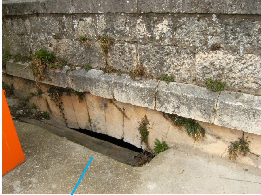
Fig. 268: Arco del pontón sobre el arroyo de la Cedorra, bajo el trazado de la carretera o calle de los Barbadillos. Abril 2.015.
