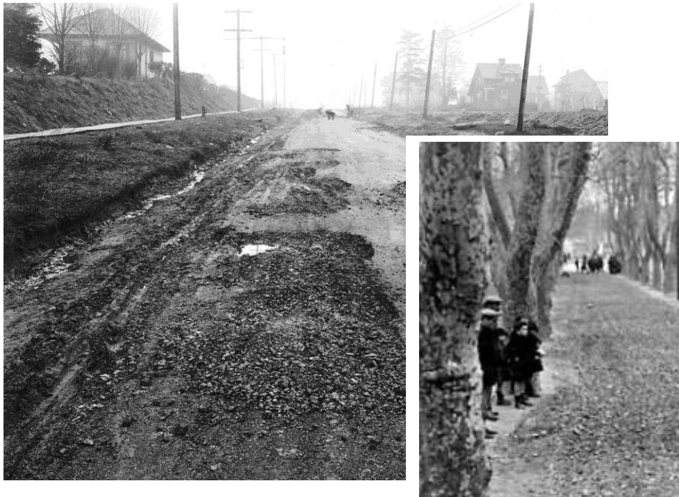
Figs. 37-38: Caminos de macadam en los que es visible su deterioro.
