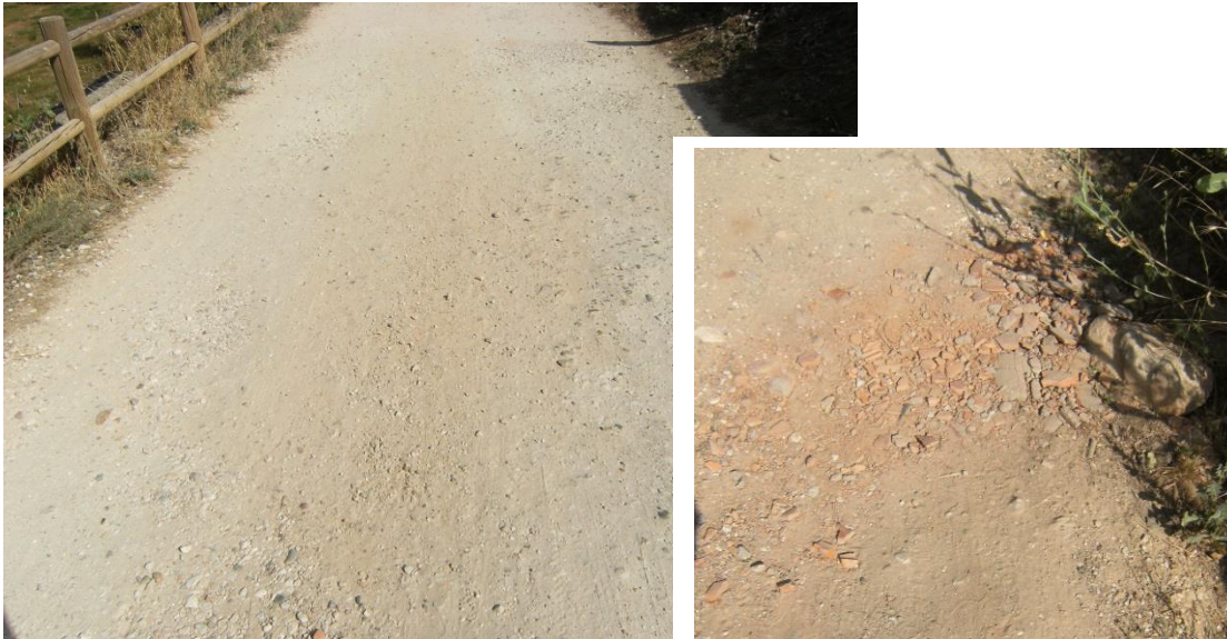
Fig. 41: Camino rural en Covarrubias siguiendo la técnica del macadam y parcheo de un bache con materiales de obra. Agosto 2.014.
