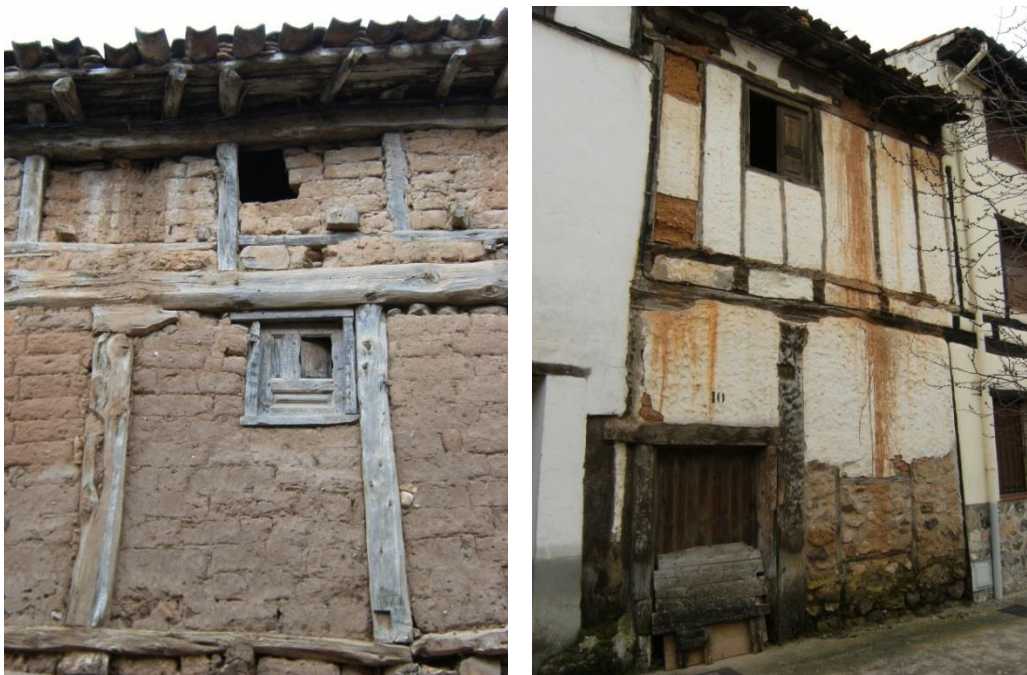
Fig. 390: Arquitectura de entramado sin rehabilitar: Tordueles y Covarrubias ( Calle San Roque). Marzo 2.014.
