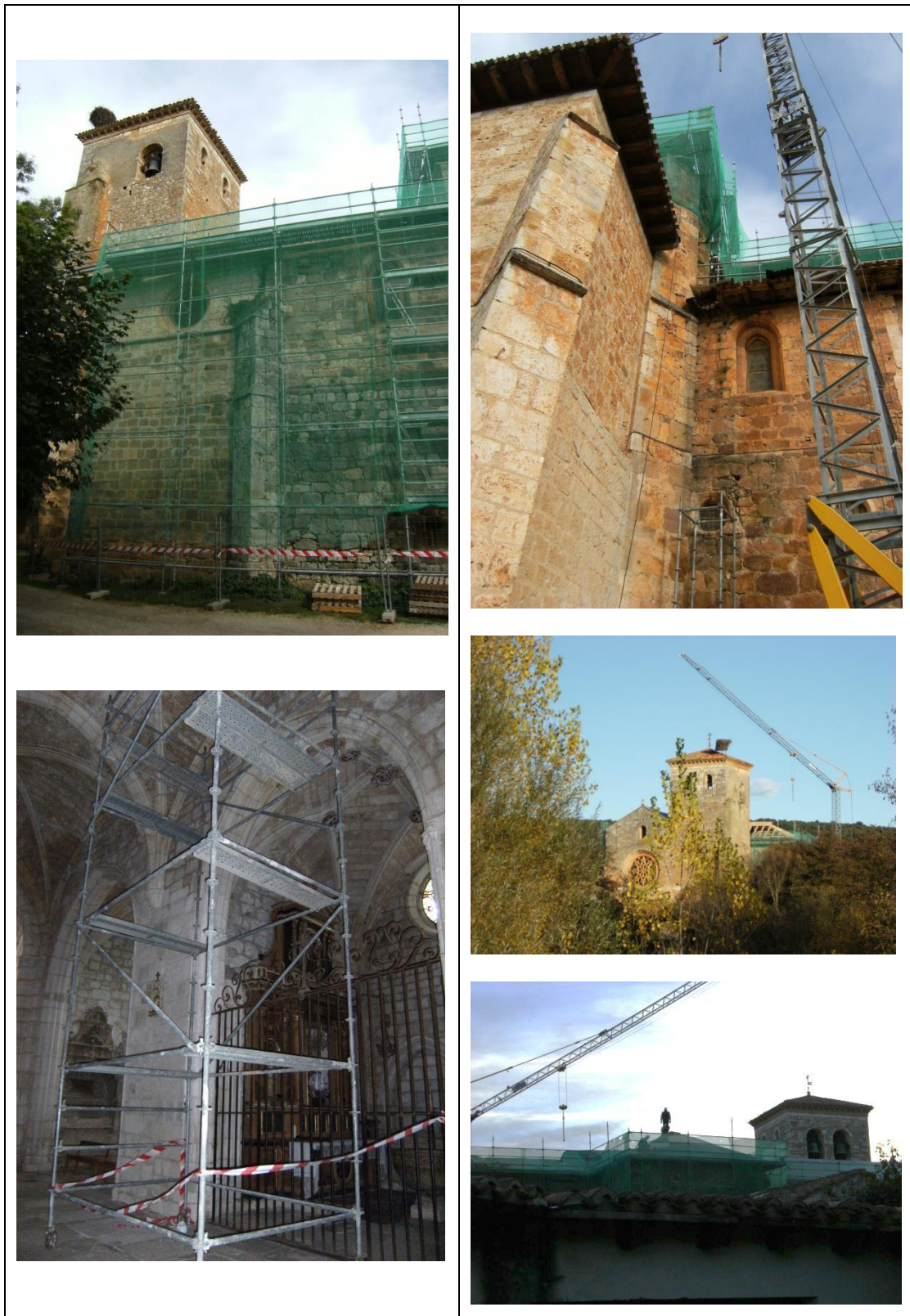
Lámina33: Distintos momentos de los trabajos sobre la cubierta e interior de la Colegial. Noviembre-Diciembre 2.014.
