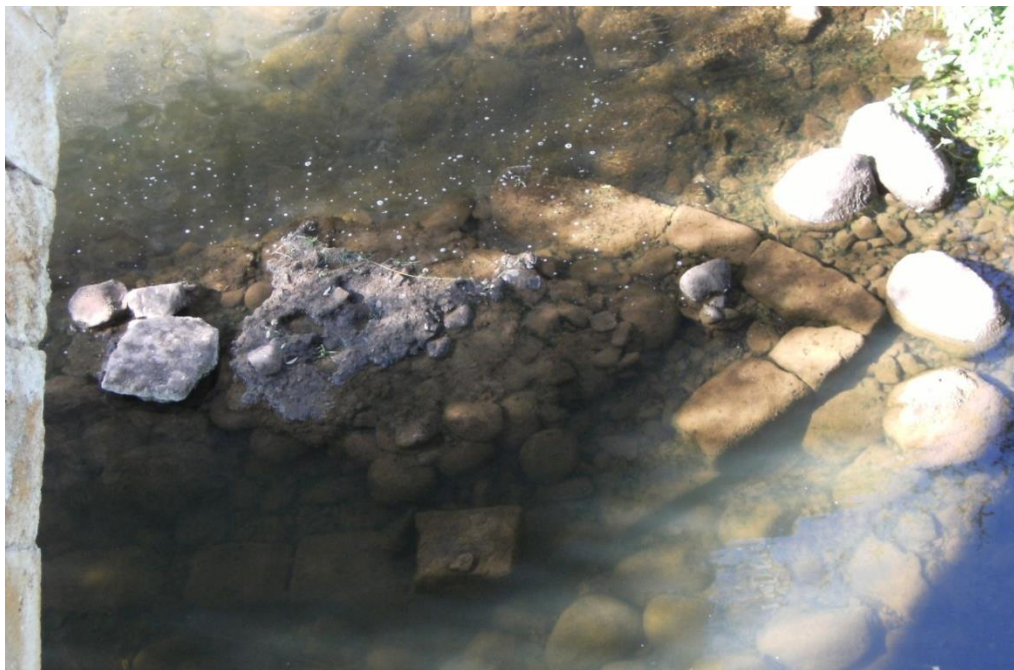
Fig. 138: Base de tajamar bajo segundo arco, vista cenital, desde el pretil del puente. Octubre 2.014.
