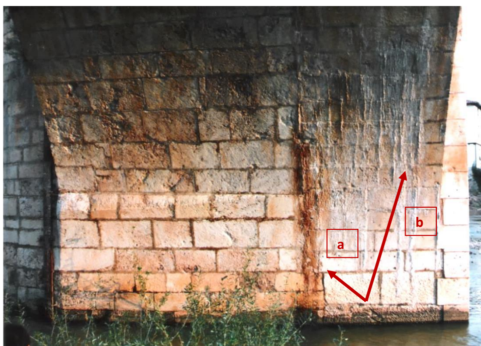
Fig. 281: Intradós sur del arco 1º: línea de corte y ampliación -a- y concreciones calcáreas por filtración en la obra nueva -b-. Agosto 1.997.
