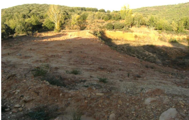
Fig. 264: Lugar sobre el que se comenzó a edificar el muro de retención del Pantano de Retuerta.
