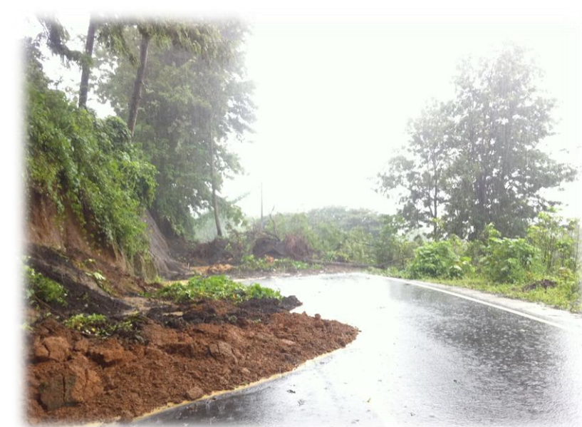
Desprendimiento del talud de una carretera próxima a El Cerrito.
