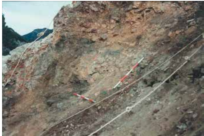
126. Fotografía. Vista del área de excavación en el interior de la turrís de Peña Partida durante la intervención. Debe señalarse la dificultad de su excavación, en una superficie pequeña, rodeada de fuertes caídas (lo que hizo necesario el empleo de medidas de anclaje y seguridad), con una sedimentología fuertemente inclinada y removida por el consiguiente arrastre de los sedimentos.
