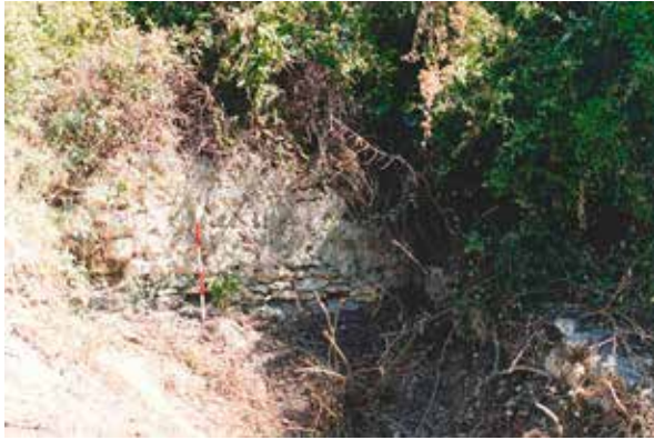
85. Fotografía. Estado inicial de la fuente antes de la intervención.
