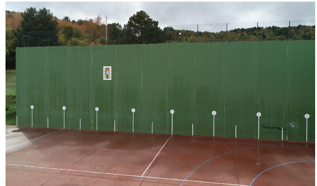
Ilustración 6: Estado del frontón y acumulación de agua en su encuentro con la pista
