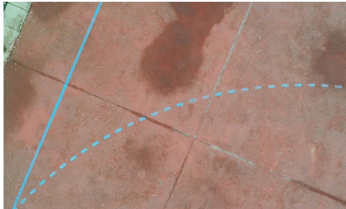
Ilustración 5: Degradación de la pista
