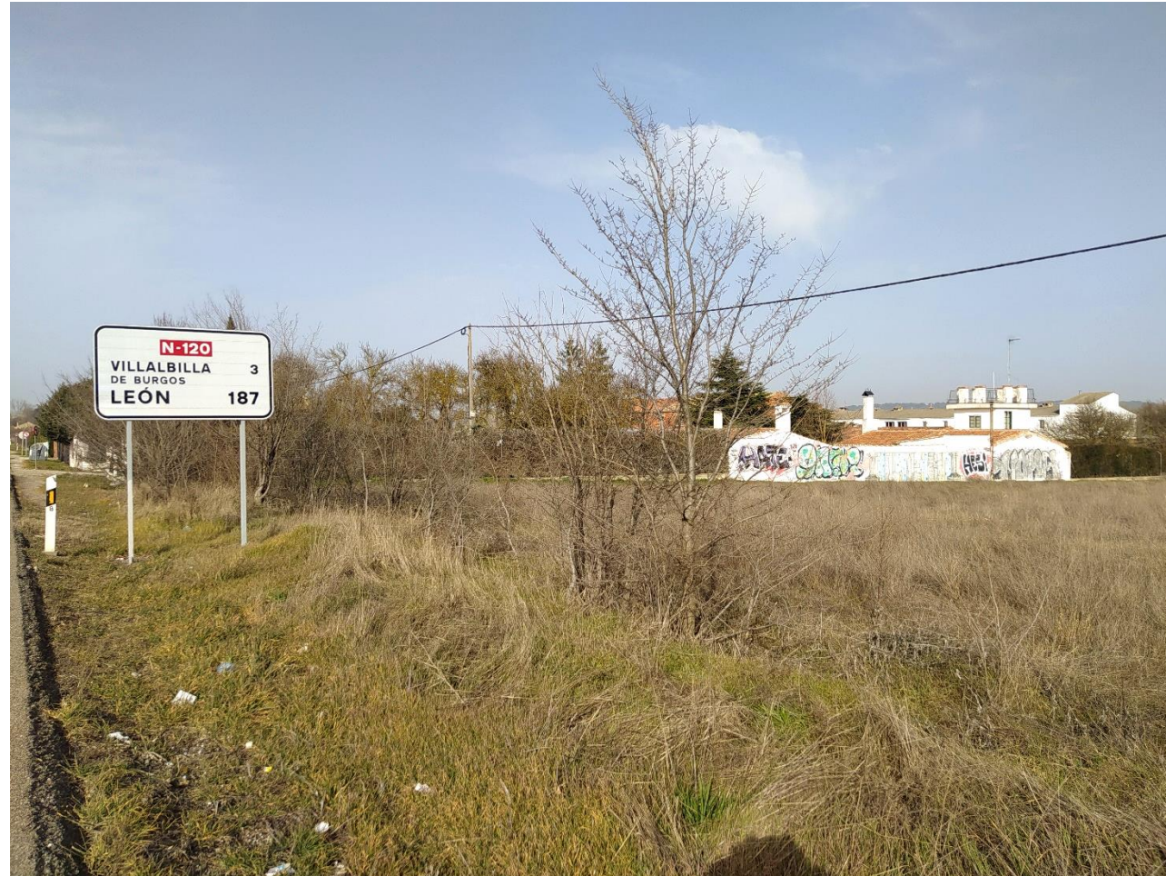
Imagen 15 Línea de baja tensión aérea sobre postes de hormigón
