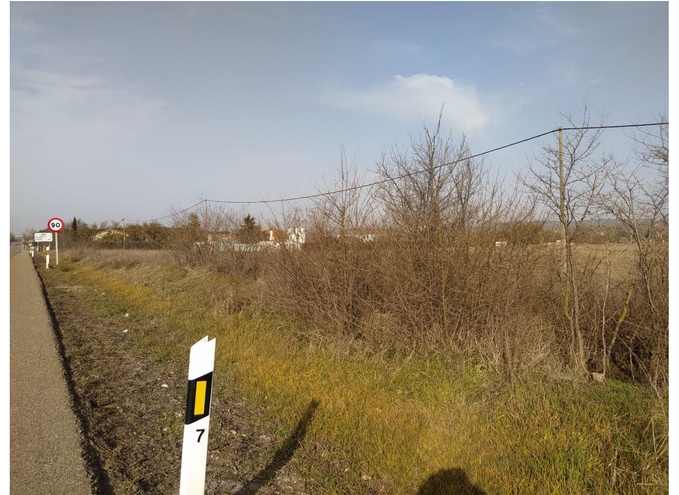
Imagen 16 Línea de baja tensión aérea sobre postes de hormigón (2)
