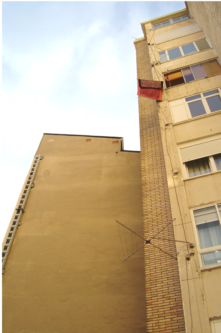
Medianería de la Iglesia del Carmen rebasando la fachada lateral derecha.
