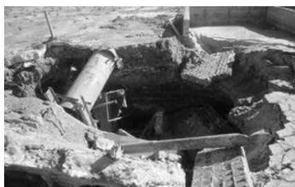
Figura 5. Situación del sondeo tras el hundimiento y cese de la salida de gas y agua.
