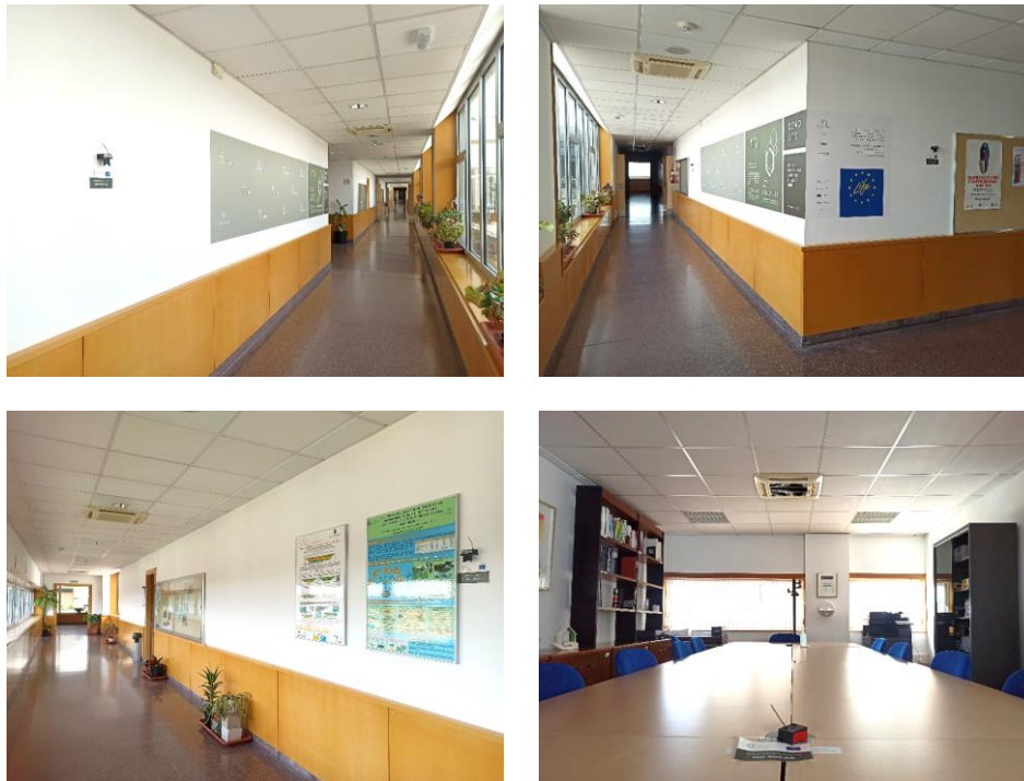
Figura 9.6. Instalación de los sensores de monitorización en el edificio de la Escuela Politécnica Superior (Milanera) de la Universidad de Burgos en Burgos (España)
