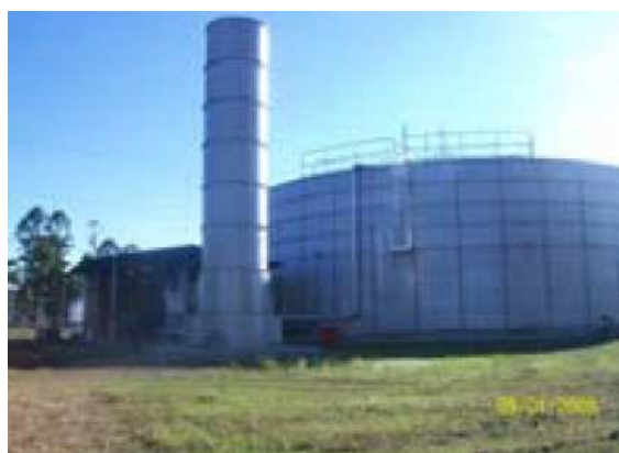
Figura 8.30. Vista del reactor UASB industrial (2).
