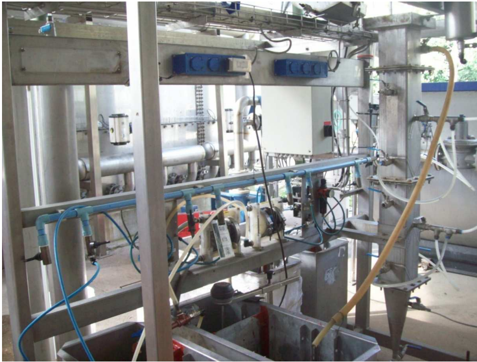
Figura 8.11. Foto de la planta piloto para tratar efluente industrial citrícola.
