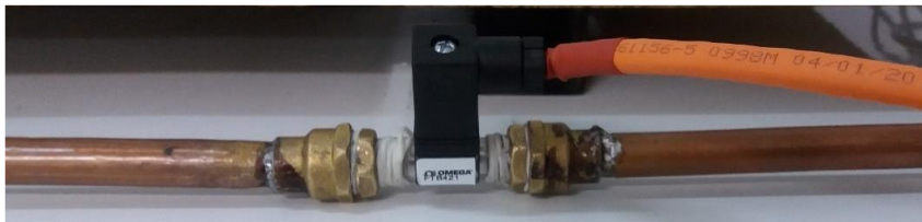
Figura III.13: caudalímetro de la instalación. Omega FTB-421
