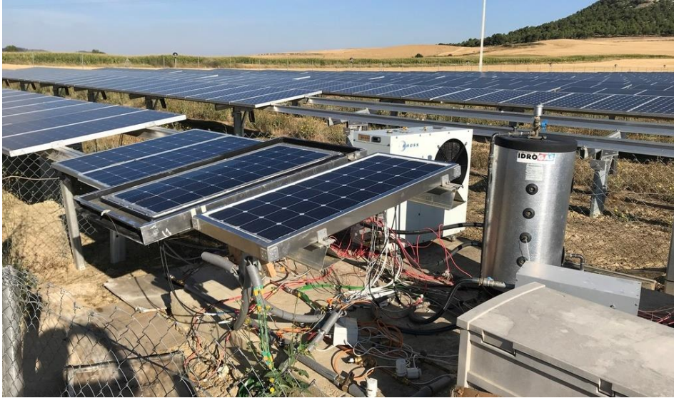
Figura III.49: Imagen del diseño final de la instalación de pruebas de paneles solares híbridos
