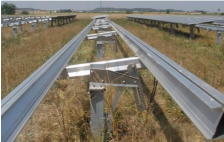
Figura III.34: Imagen de las estructuras de soporte de paneles fotovoltaicos donde se colocarán los paneles híbridos. Tienen orientación sur y permiten regulación de la inclinación
