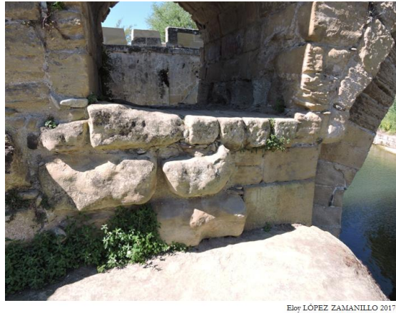
Figura 29: Restos sillería romana puente de Cihuri, (La Rioja).
