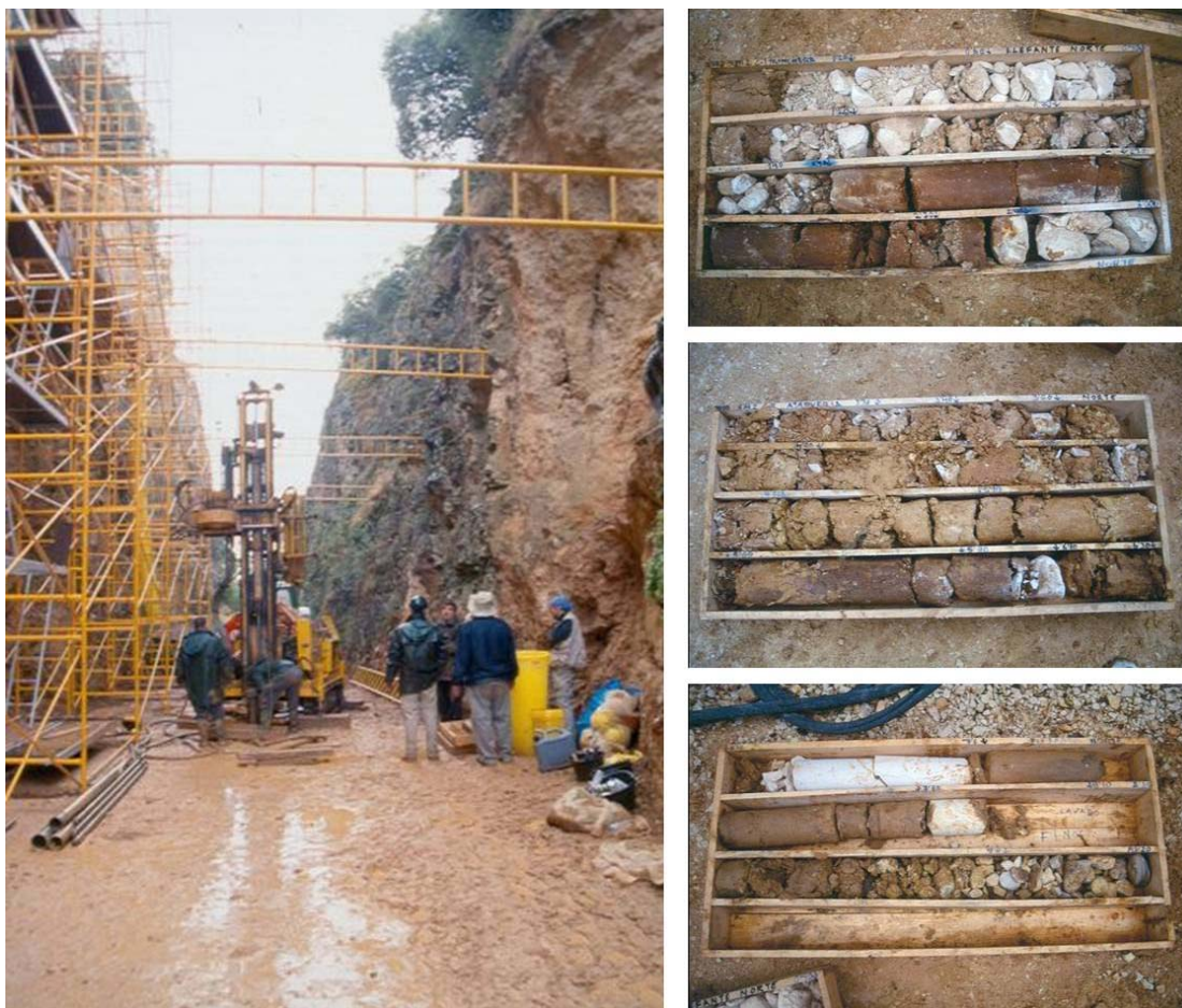
Figura 4.148 Sondeos mecánicos en la base del sector de Elefante con referencias del testigo recuperado (Fotografías: M. A. Martín)
