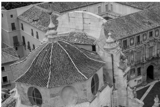
Fig. 14. Vista desde la torre de la parte posterior de la fachada de la catedral, cúpula del trascoro y cubiertas del palacio episcopal (Fotografía M. Saura).
