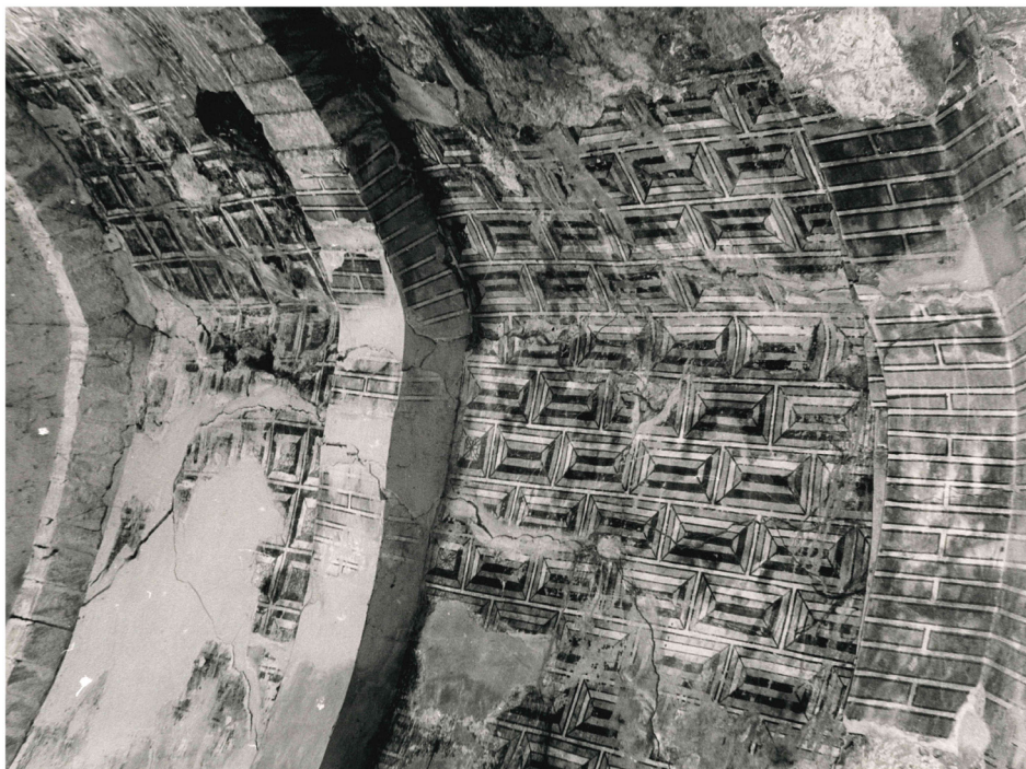
Fig. 5. Ermita de Santa Catalina de Ciriza. Azcona. Bóveda con casetones y almohadillado en 1982. Foto: Arzobispado de Pamplona y Tudela.
