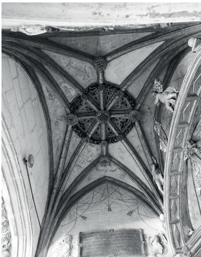
▲ Figura 19 Bóveda de la capilla de la Ascensión de la abadesa Isabel de Mendoza y Navarra del Monasterio de Las Huelgas Reales de Burgos.
