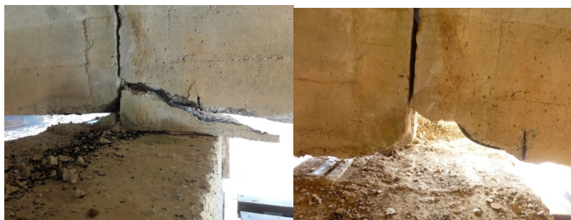
Figura 07: Cabezas izadas, disgregadas y aparatos de apoyo.
