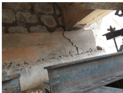
Figura 06: Fisuras en mesetas de apoyo
