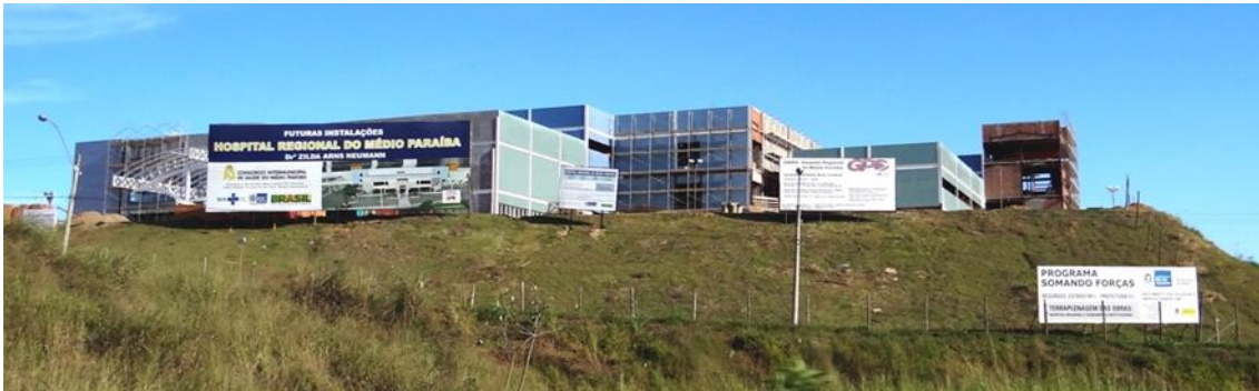
Figura 13. Construção do Hospital Regional do Médio Paraíba, localizado no entroncamento viário da Via Dutra com o acesso a Volta Redonda. Julho de 2012. Fonte: Arquivo da Pesquisa.
